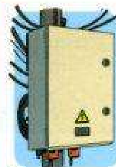
Щит уличного освещения
